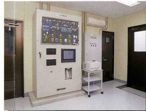
浸出水処理施設監視盤
