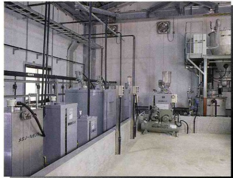
薬品注入設備
