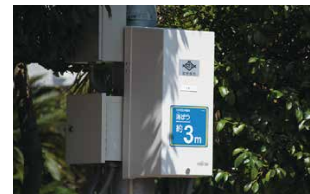
子局のアンプ類ボックス部分に貼られた海拔表示。現在、市内約80カ所に表示されている
