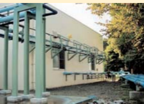
再生水処理施設
