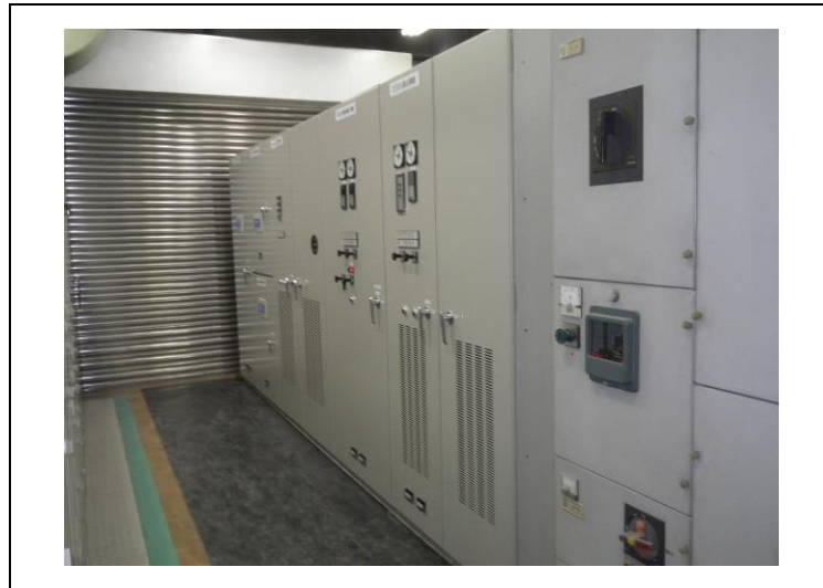
【中部下水処理場 汚泥工場1階受変電設備】
