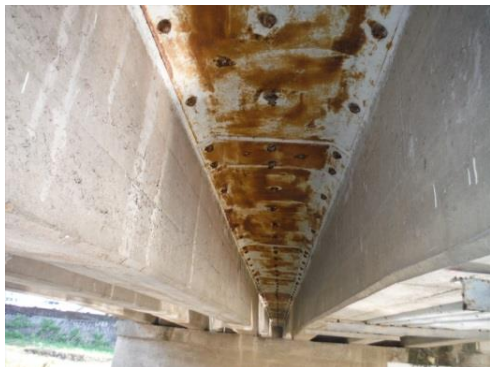
〔老朽が著しい相浦橋の状況〕
