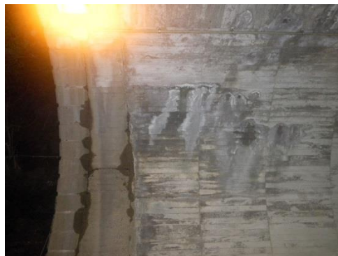
〔老朽化が進む石岳隧道の状況〕
