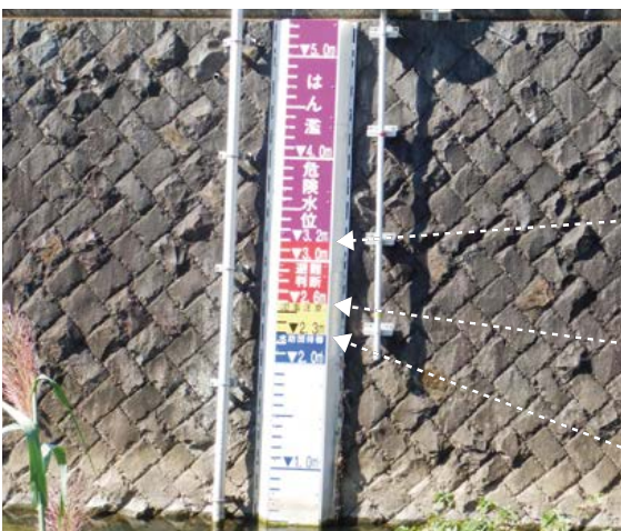
佐世保川(県北振興局)の量水標 (市役所裏に設置しています。)
