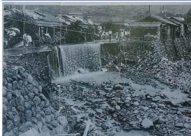
黒髪小学校前の護岸崩壊（昭和42年7月の豪雨）
