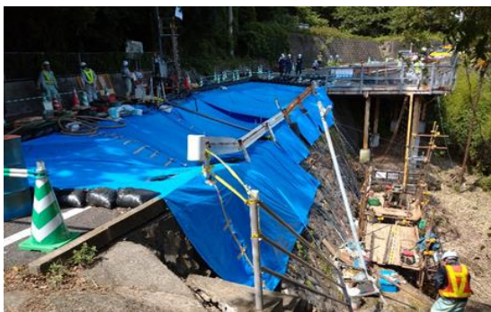
〔令和 2 年 6 月 25 日の御船町道路崩壊の様子〕
