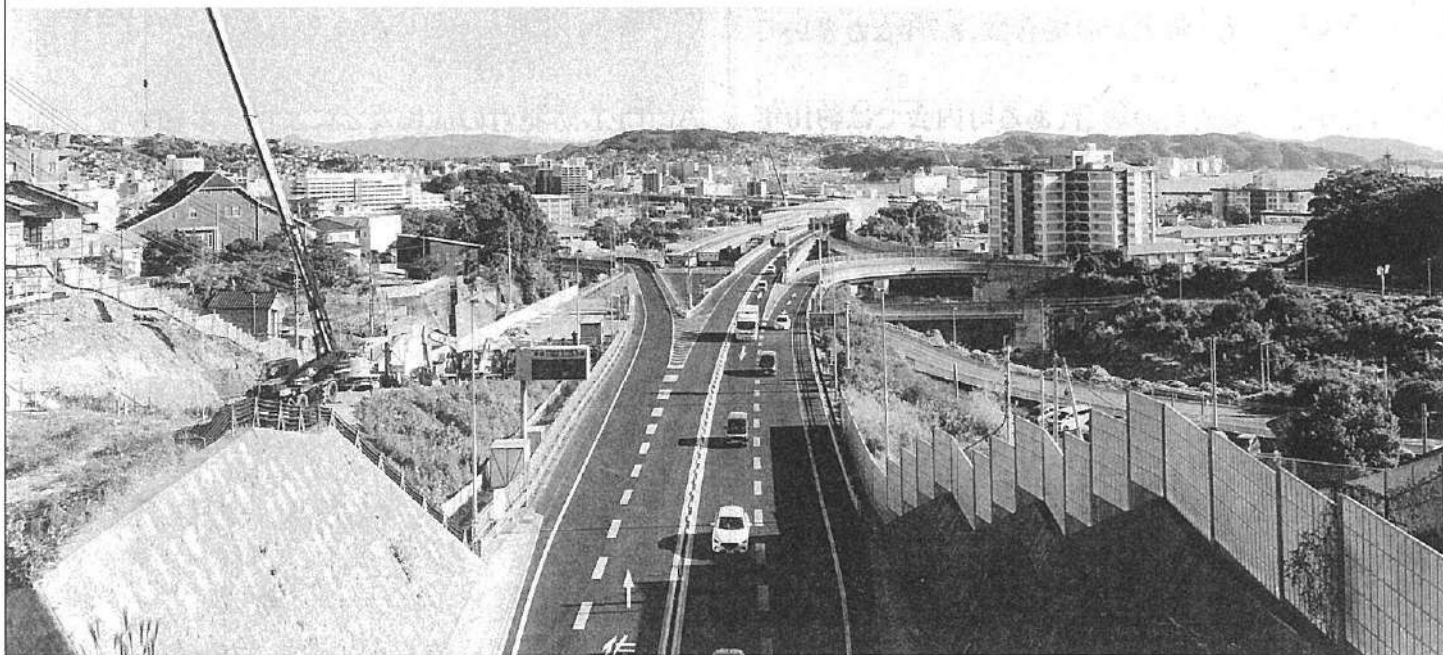
令和9年度の供用開始を目指し4車線化工事が進む西九州自動車道(佐世保道路)
