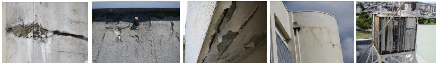
市内公施設においてみられる劣化の状況
