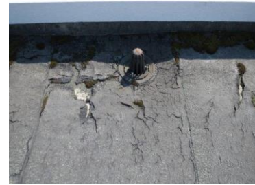
屋上防水が劣化し、ひび割れや剥離しており、機能を果たしていない (D評価)
