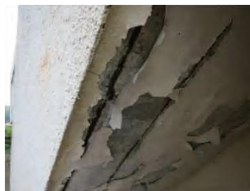
軒裏で鉄筋の腐食により躯体が爆裂し、コンクリート片が剥落 (D評価)
