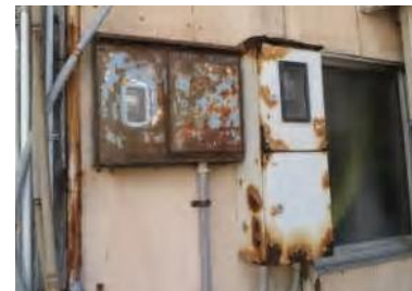
屋外受電盤の全体に発錆、腐食がみられ、漏電等による火災の恐れがある (C評価)
