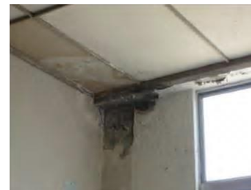
壁面及び天井面に外部から漏水により、塗装が剥がれ、天井のボードの落下の危険性がある。(D評価)
