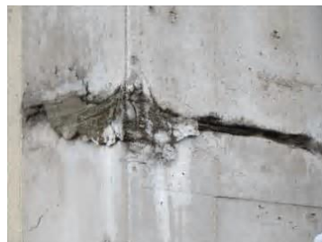
柱のコンクリートが爆裂し、内部の鉄筋が露出 (D評価)
