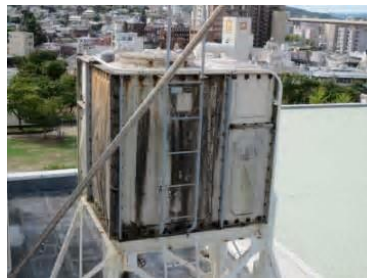
高置水槽に全体的に錆びや汚れがあり、ボルト接合部が腐食 (D評価)
