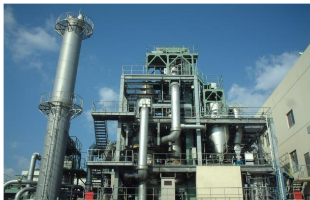
汚泥溶融処理施設（中部下水処理場）
