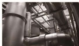
プラント配管
