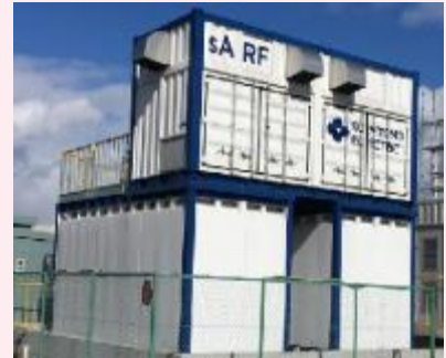
写真 大型の蓄電池
