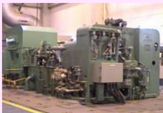
写真 蒸気タービン発電機（東部クリーンセンター）
