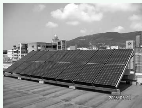
▲ ささぼエコプラザ（戸尾小学校跡）の屋上に設置しているソーラーパネル (4kw)
