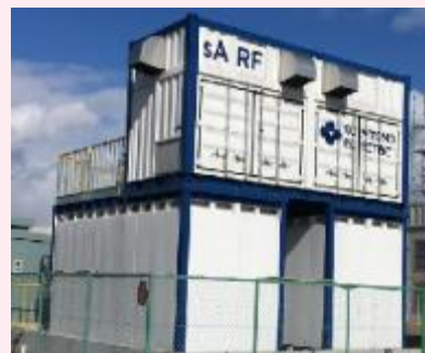
写真 大型の蓄電池
