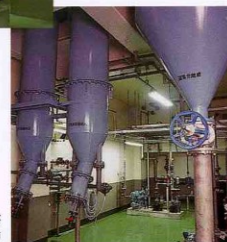
活性炭吸着塔 凝集分離槽
