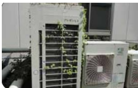
室外機に蔦が絡んでいる場合や、障害物がある場合は、速やかに除去してください。
