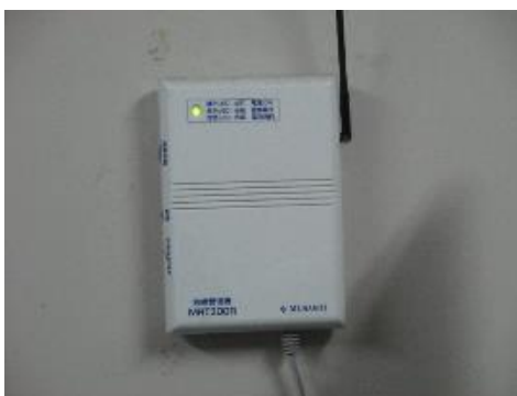
デマンド監視装置
