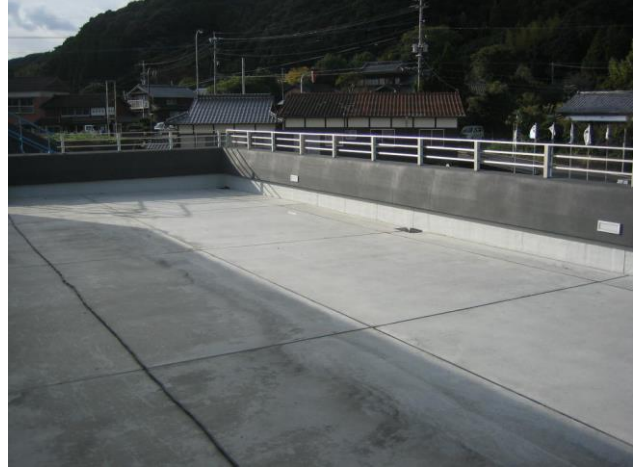
写真-2 2階屋上テラス部仕上状況 (アスファルト屋根保護防水密着断熱工法)
