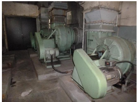
(中部下水処理場 水処理脱臭設備)
