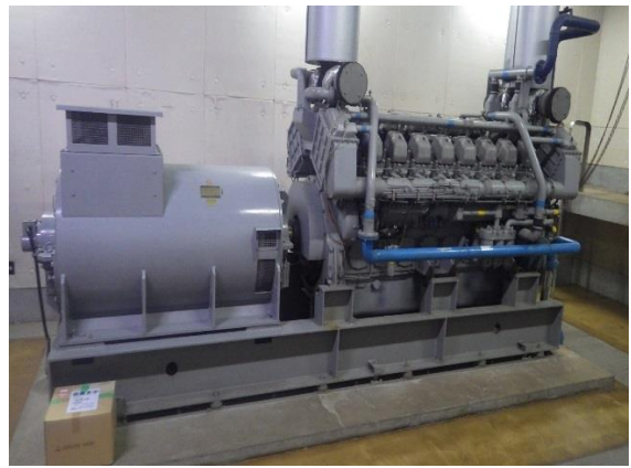
(中部下水処理場 自家発電設備)
