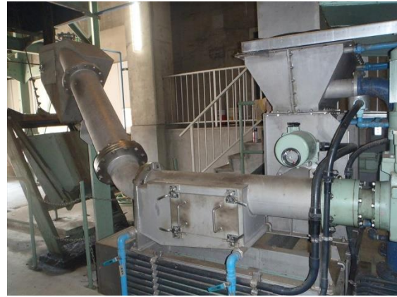
(平瀬ポンプ場 沈砂池設備)
