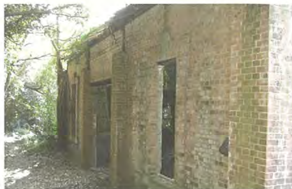
田代3番建物(発電所)
