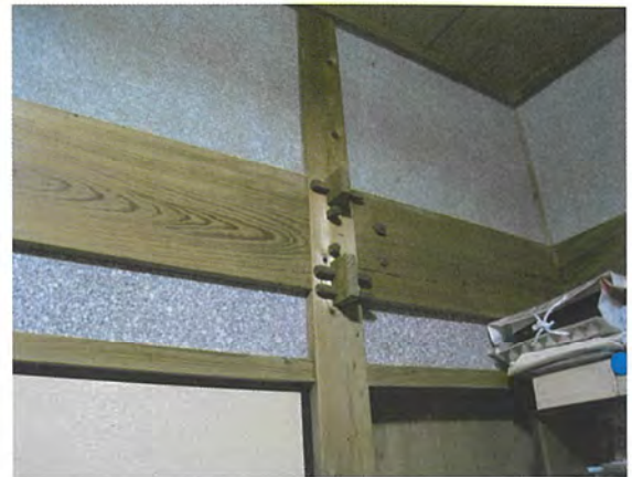
蕨集落 M 氏宅柱、梁接合部
