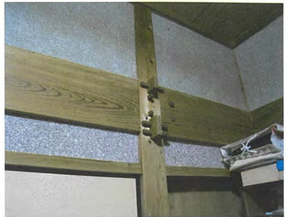
蕨集落 M 氏宅柱、梁接合部
