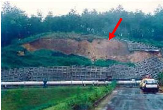
写真 37：堤体付近の法面(崩壊後)
