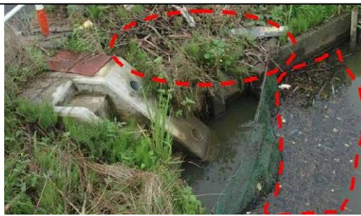
写真 34：取水部周辺の土砂やゴミの堆積
