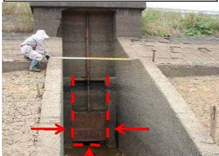
写真 33：ゲート周りの漏水
