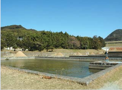
砂や砂利を使用して水を浄化する施設(緩速ろ過池)
