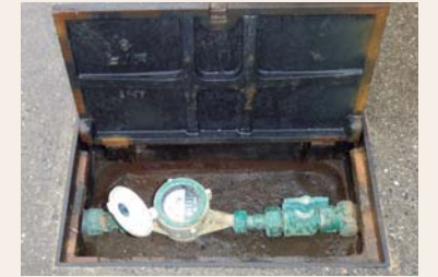
水道メーター
