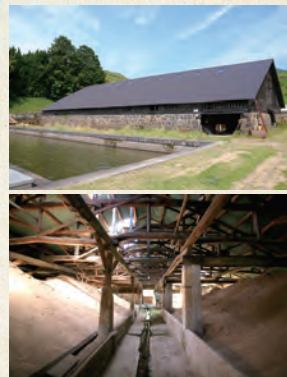
佐世保市水道局山ノ田浄水場濾砂倉庫 (旧海軍水道山ノ田水源地砂置場) 木造平屋 明治41(1908)年 緩速ろ過の必需品である砂を洗い、保管した建物。ここまで大きな規模の建物で和風の小屋組みを選択した理由については不明。自然に曲がった木を巧みに組み合わせて構成された大空間と、積み上げられた砂の山が見る者を圧倒する。
