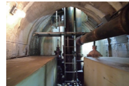
100年以上使用している山の田ダムの取水設備
