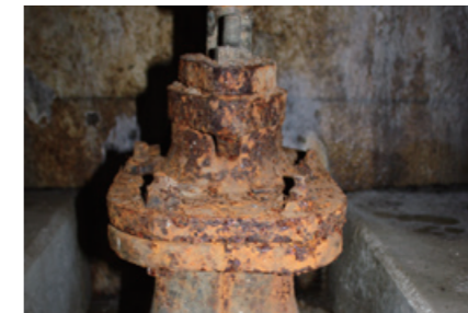
左の取水設備のうち、取水の生命線とも言える取水バルブ(山の田ダム)
