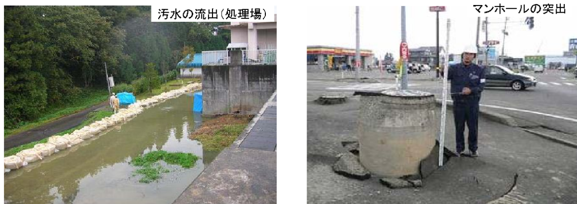
図 8.6 新潟県中越地震における下水道施設の被害の状況
