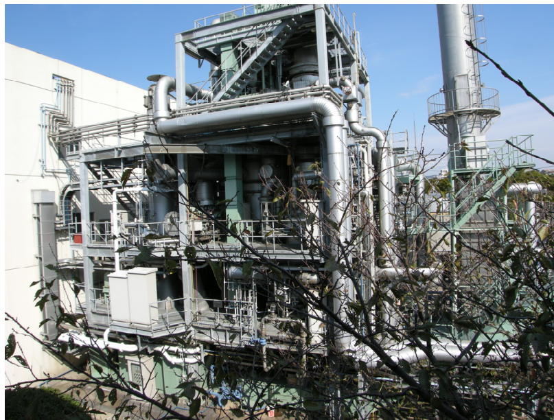
図 8.10 汚泥溶融施設（中部下水処理場）
