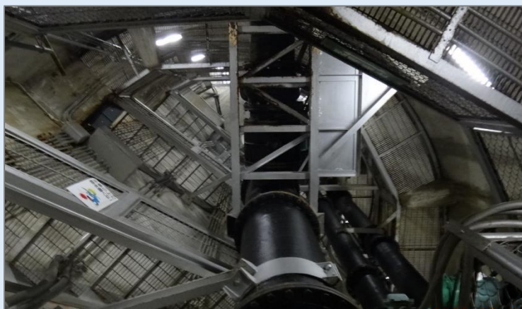
広い空間に設置された取水塔
