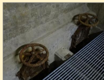
錆で覆われた排水バルブ
