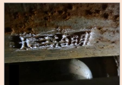
「明治39年」の刻印がある導水管
