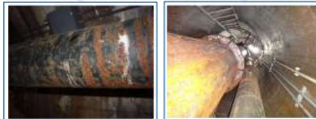
老朽化した取水施設
