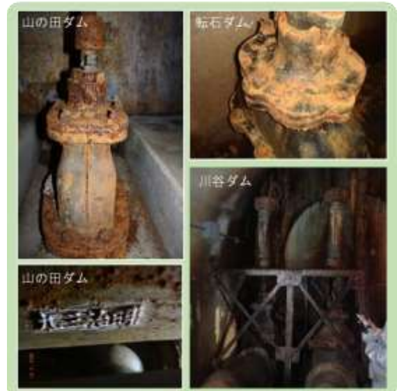
ダムの老朽化した付属施設
