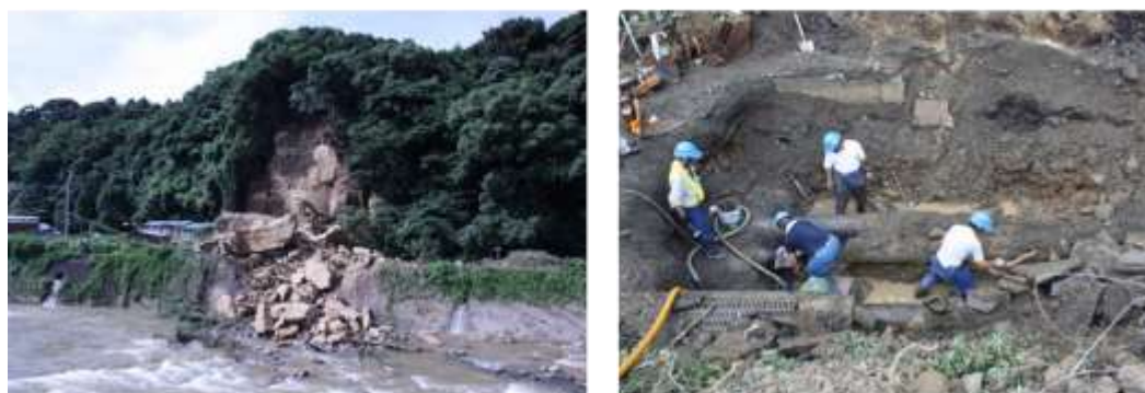
H21瀬戸越崩落事故の様子
