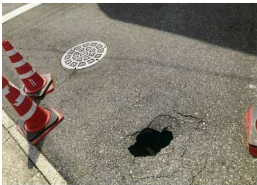
他都市で発生した道路陥没事故の様子
