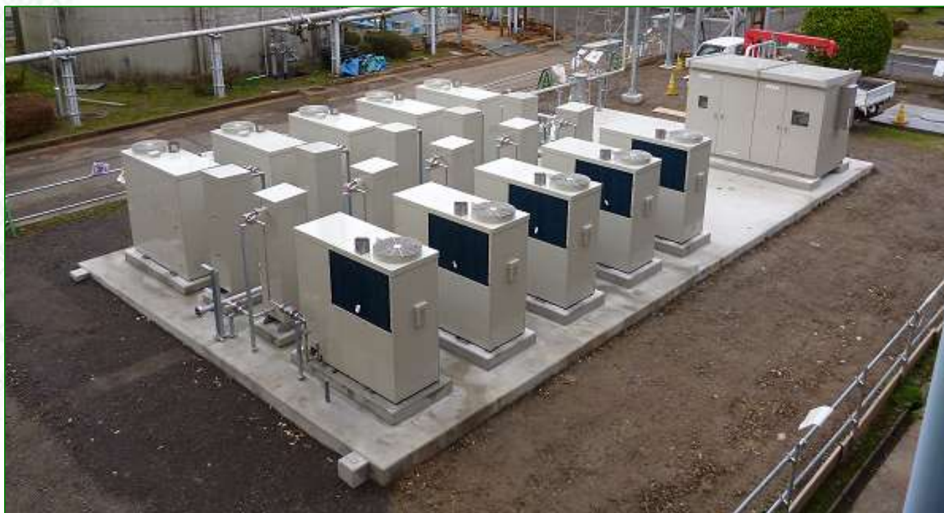
消化ガス発電設備の写真
