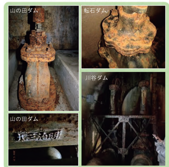
ダムの老朽化した付属施設
