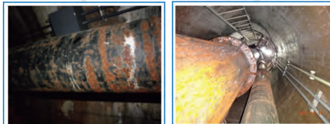
老朽化した取水施設
