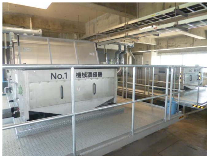
【中部下水処理場 機械濃縮設備】
