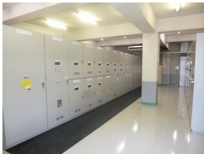
【中部下水処理場 受変電設備】
