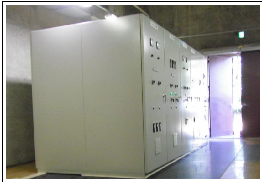
【平瀬ポンプ場受変電設備】
