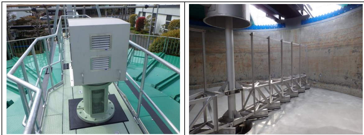
【重力濃縮 設備】
