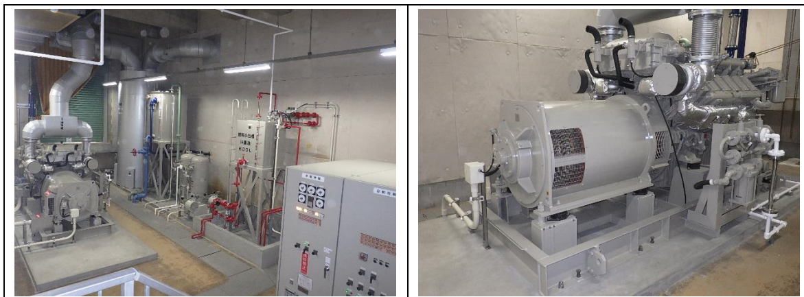
【自家発電 設備】
