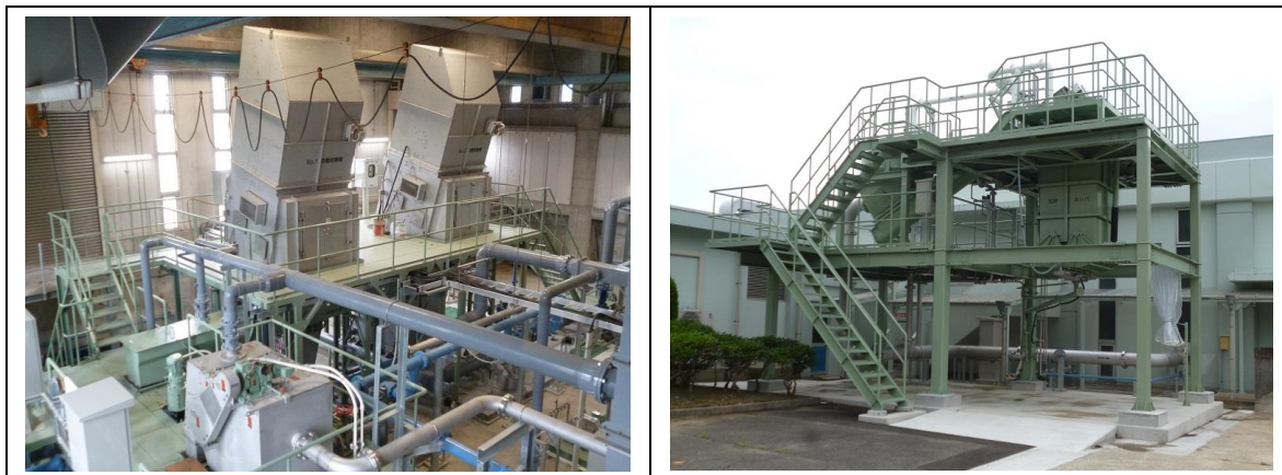
【第 1 沈砂池 設備】
