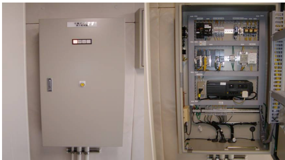
【遠方監視装置整備（ポンプ所等）】
