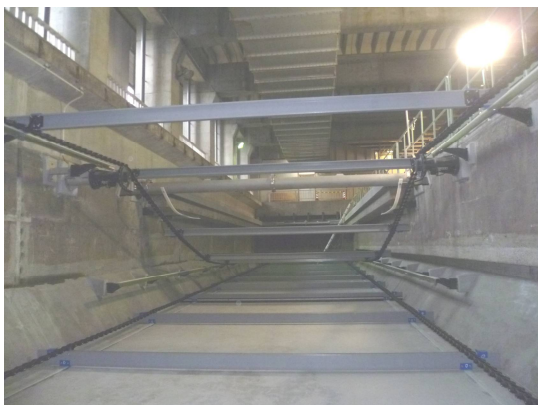
【中部下水処理場 汚泥掻寄機設備】
