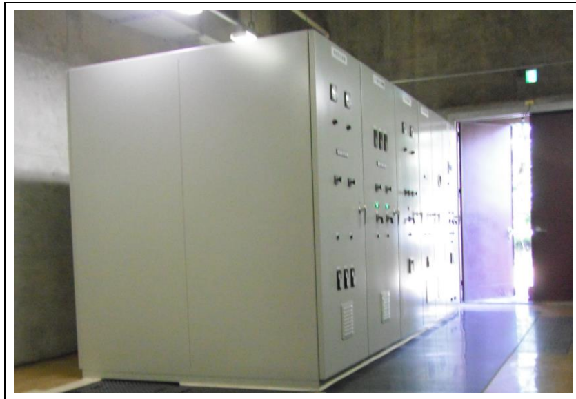
【平瀬ポンプ場受変電設備】
