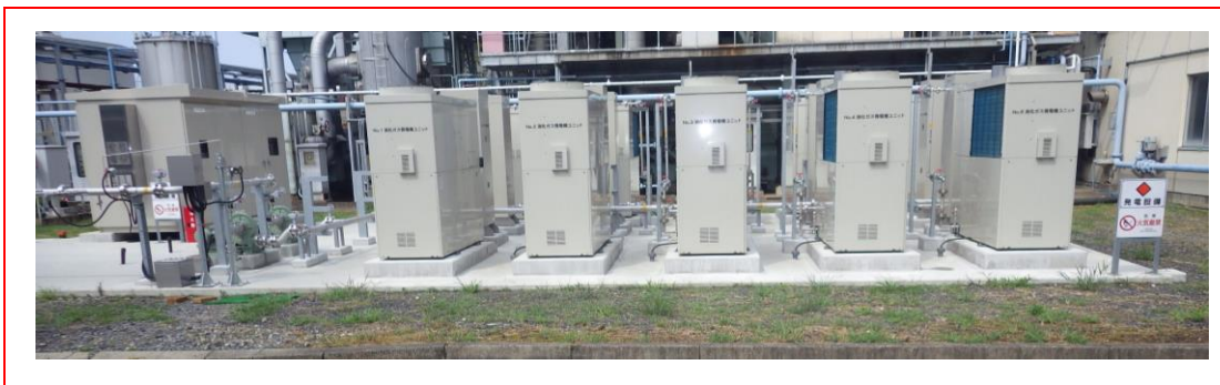
【消化ガス発電設備】
