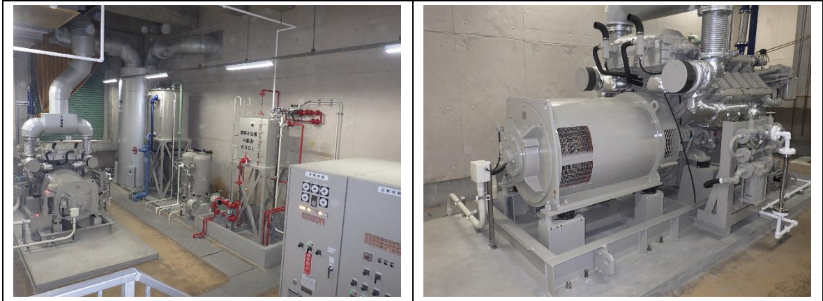
【自家発電 設備】
