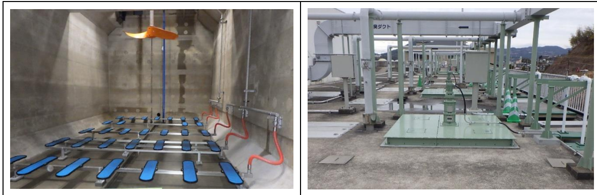
【2系水処理設備】
