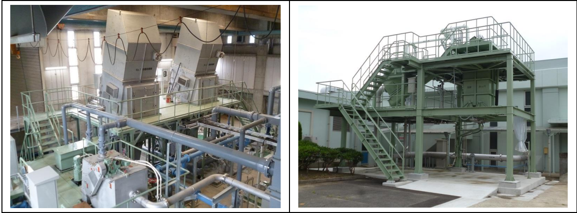
【第1沈砂池 設備】
