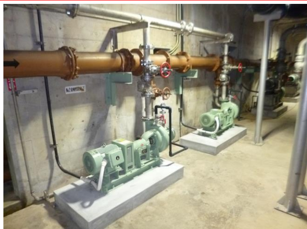
【1,2系 返送・余剰汚泥ポンプ設備】
