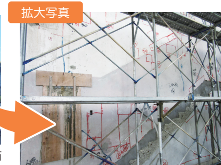
壁の補修箇所印がつけられている
